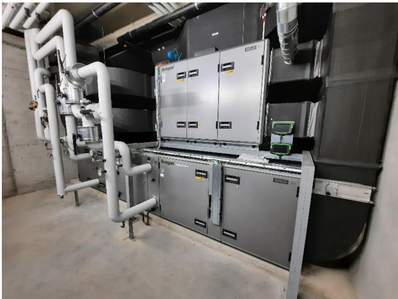
Foto 2: particolare delle unità di trattamento aria a servizio del Factory Shop.
