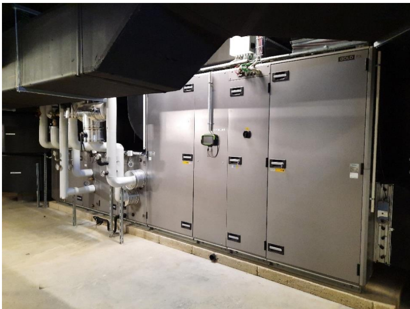
Foto 3: particolare della UTA a servizio della sala conferenze.
